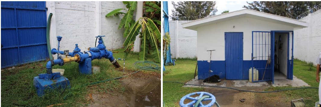
Figura 148. Imágenes del muestreo del pozo 15 Juan de la Barrera, en San Pedro Tlaquepaque
