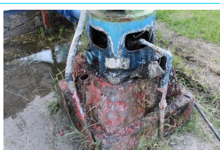
Pozo oxidado y carcomido
