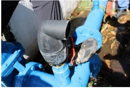
Tubería de escape de aire (negro)
